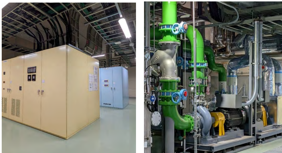
図表 130 明示的に色分けされた配電盤やパイプ
