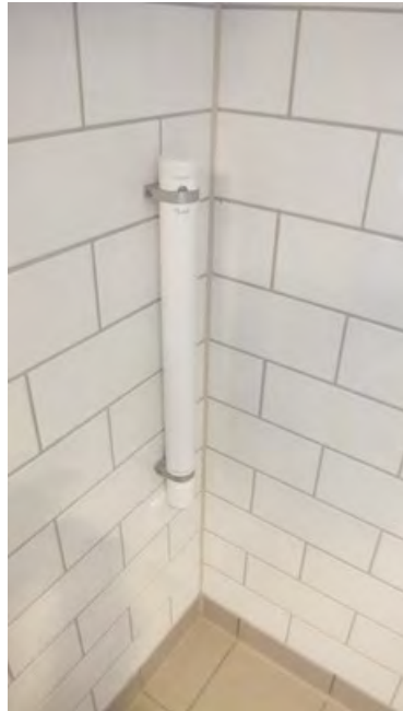
図表 149 トイレ・浴室に設置されている光センサー
